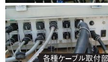
各種ケーブル取付部
